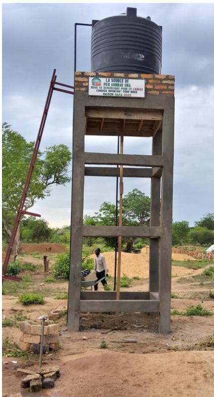
Vanntårnet rommer 7000 liter vann og gir trykk til vannposter ved skolen. En pumpe drives av strøm fra solceller.
